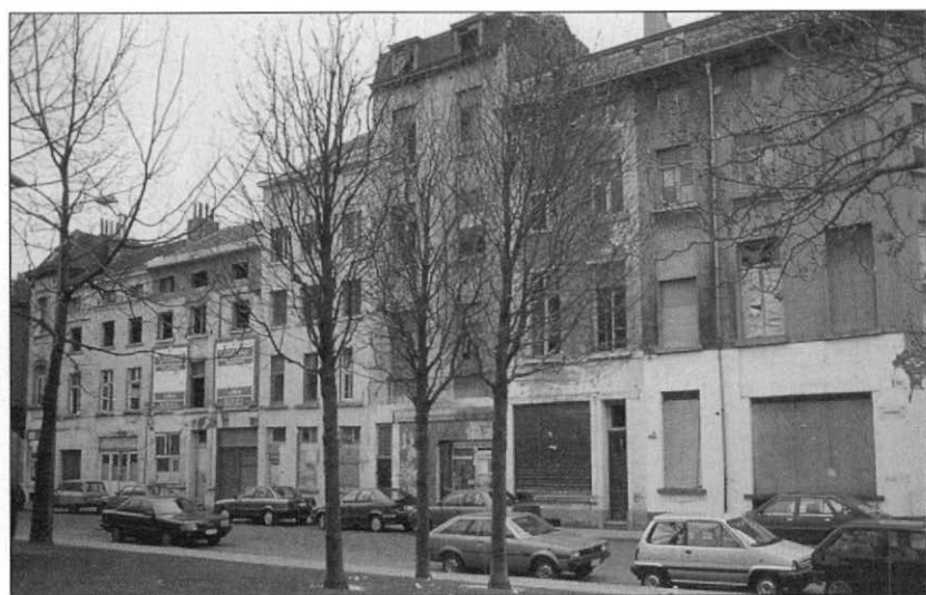
GOMB-project Harmoniebuurt. De verkrotte woningen Harmoniestraat 20-36 in 1989.
