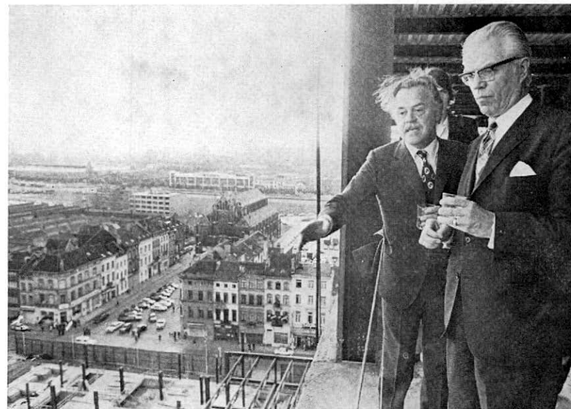
C. De Pauw en Minister De Saeger bij de eerste steenlegging van de eerste W.T.C.-toren op 22 juni 1971. Op de achtergrond : Antwerpse Steenweg, St.-Rochusvoorplein en -kerk.
